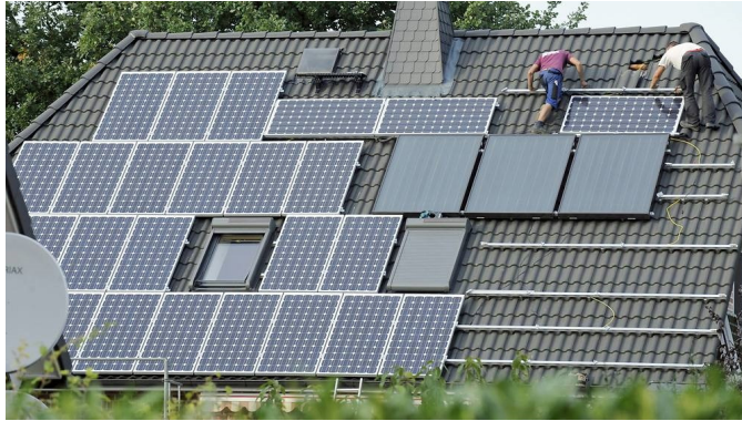
Abb. 2.16: kombinierte Photovoltaik- und Solarthermieranlage
